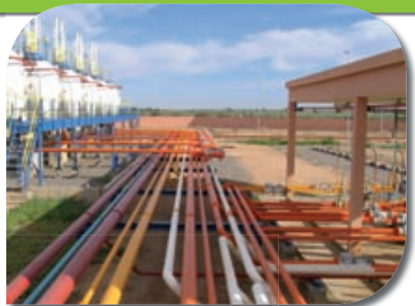
Réseau de tuyauterie GPL, Salamgaz, Marrakech, Maroc
